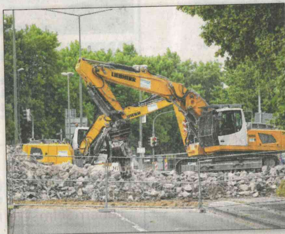
Samstag am Vormittag lag der Brückenbogen in Trümmern. Foto: Magalski
